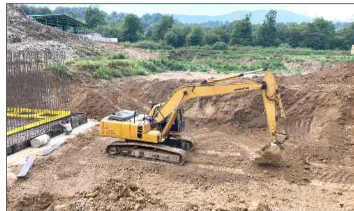
سازه‌های اصلی در دست اجرا قرار دارد. مازندران با تأکید بر اهمیت این پروژه در حوزه مدیریت پسماند و ارتقای شاخص‌های معاون هماهنگی امور عمرانی استاندار
