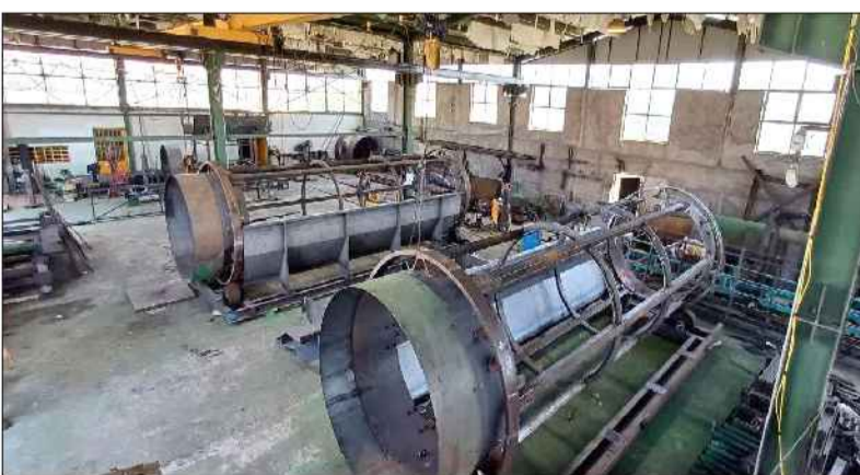
مجموعه تجهیزات تخصصی شامل سرندهای تفکیک، خطوط نوار نقاله، واحدهای خردکن و سیستم‌های جداسازی سبک و سنگین به سایت منتقل شده و عملیات مونتاژ آن‌ها با سرعت در حال انجام است. «با بهره‌برداری از خط فاین، بخش قابل‌توجهی از مواد قابل بازیافت از جریان ورودی پسماند جدا می‌شود که علاوه بر رسیدن به کاهش دفن تا حد نزدیک به صفر، موجب افزایش راندمان فرآوری و کاهش اثرات زیست‌محیطی خواهد شد.»
